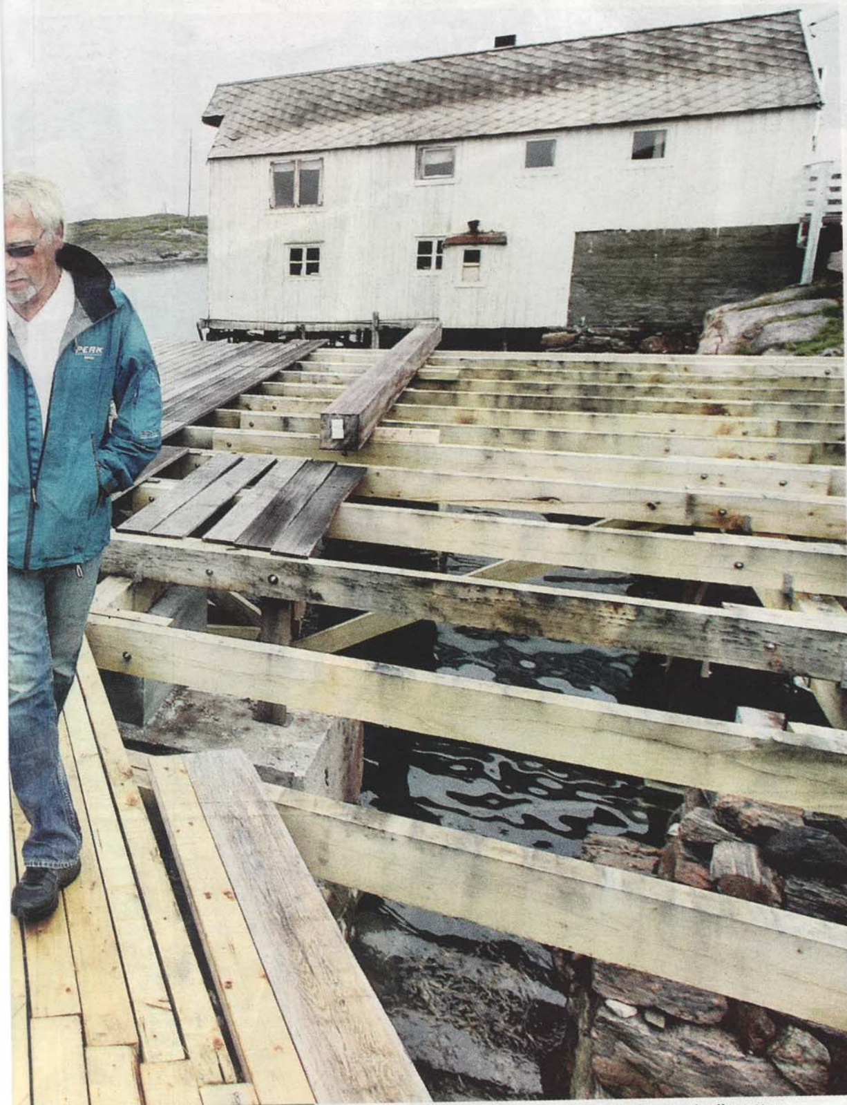
Forarget ordfører Albert Larsen (H) midt i kaikonstruksjonen som er ulovlig satt opp i Ansteinsundet. Nye betongfundamenter er plassert på de gamle for å heve kaia. Ordføreren fnyser av argumentene om havnivået som stiger. Foto: GLEN MUSK
